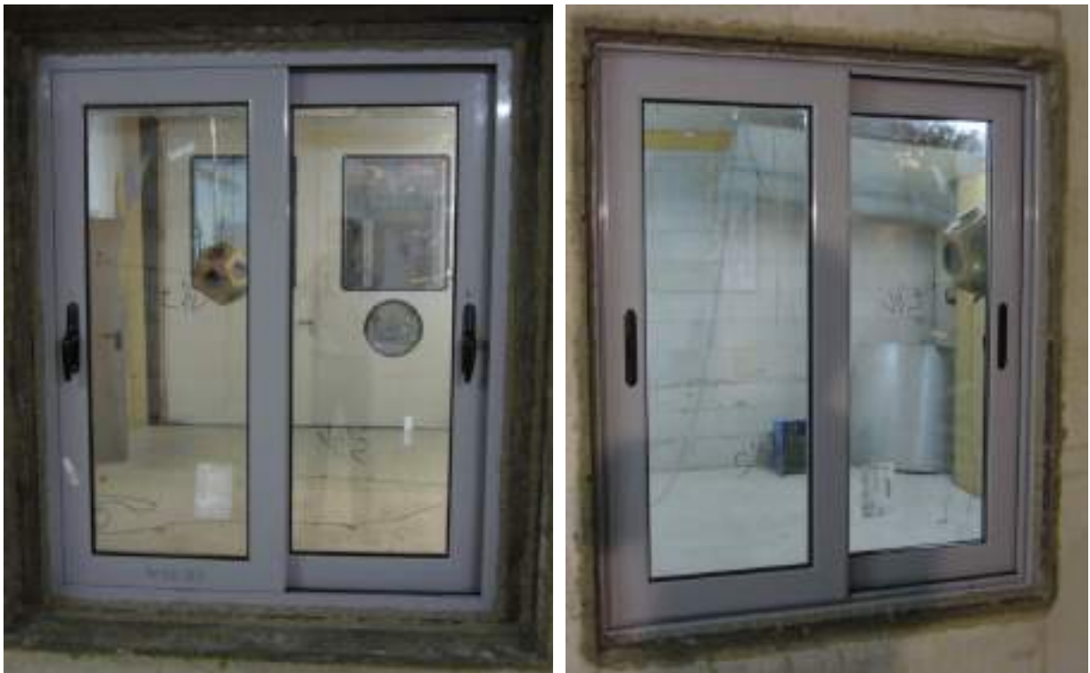
Bild 1 Fotos des eingebauten Elementes, links vom Empfangsraum aus, rechts vom Sende- raum aus, erstellt vom ift Schallschutzzentrum
